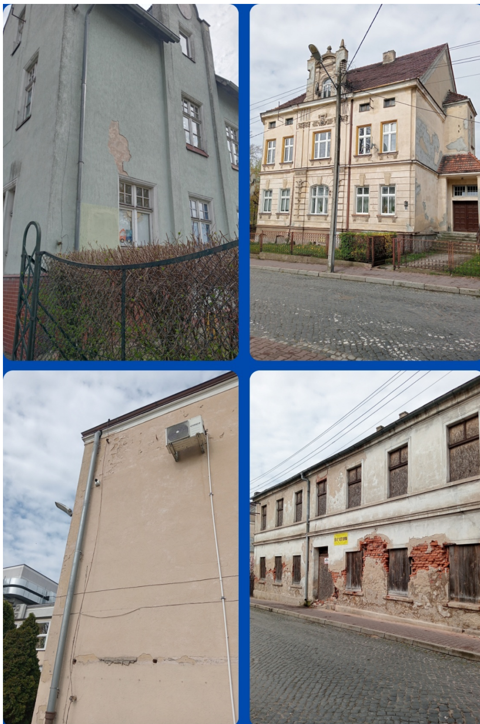
Rycina 21 – Zły stan techniczny budynków na podobszarze rewitalizacji Ś2
